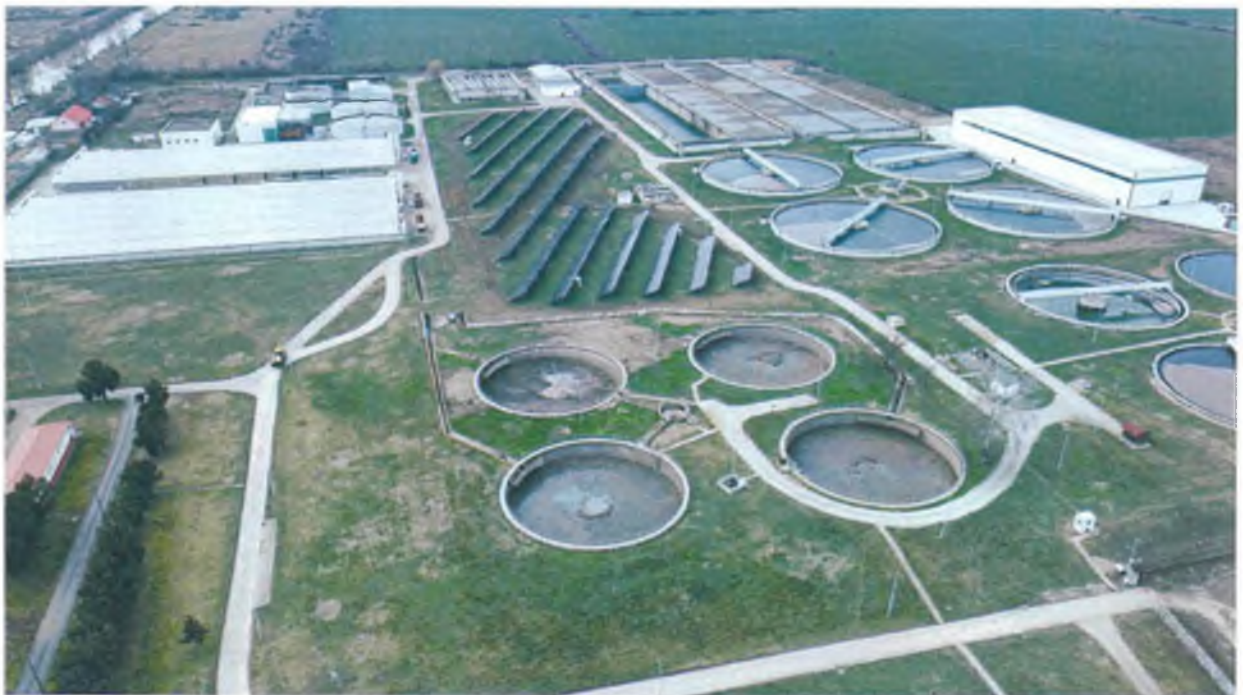
Poza 4. Stația de epurare Timișoara
