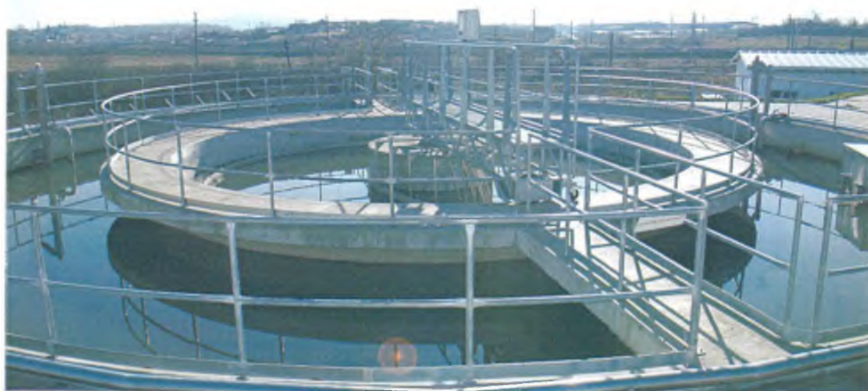
Poza 2. Stația de epurare Buziaș
