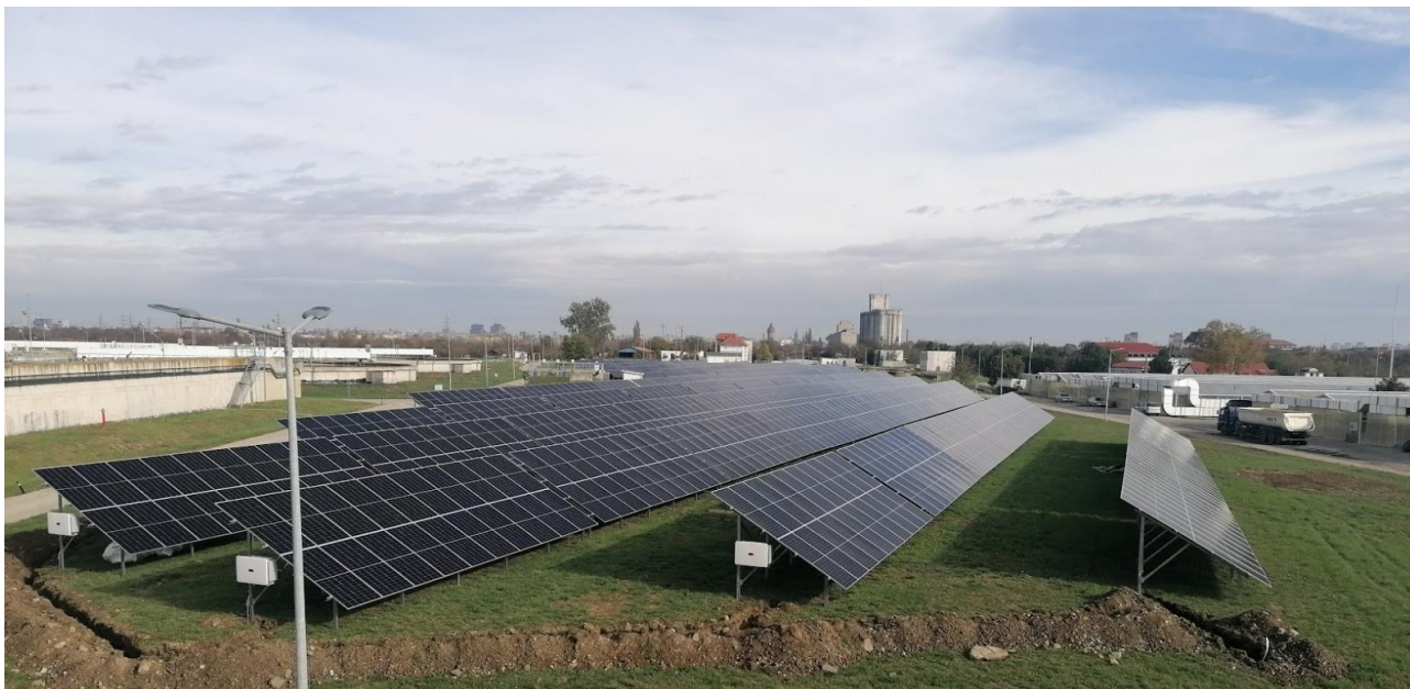
Centrală fotovoltaică, stația de epurare Stan Vidrighin, Timișoara (sursa: Aquatim)
